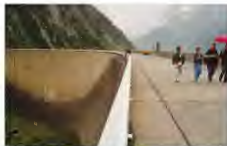
Auf der Mauer: Nässe von allen Seiten
